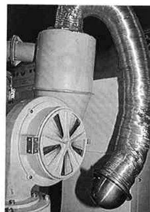
ホッパーに取り付けた蛇腹状の パイプ
